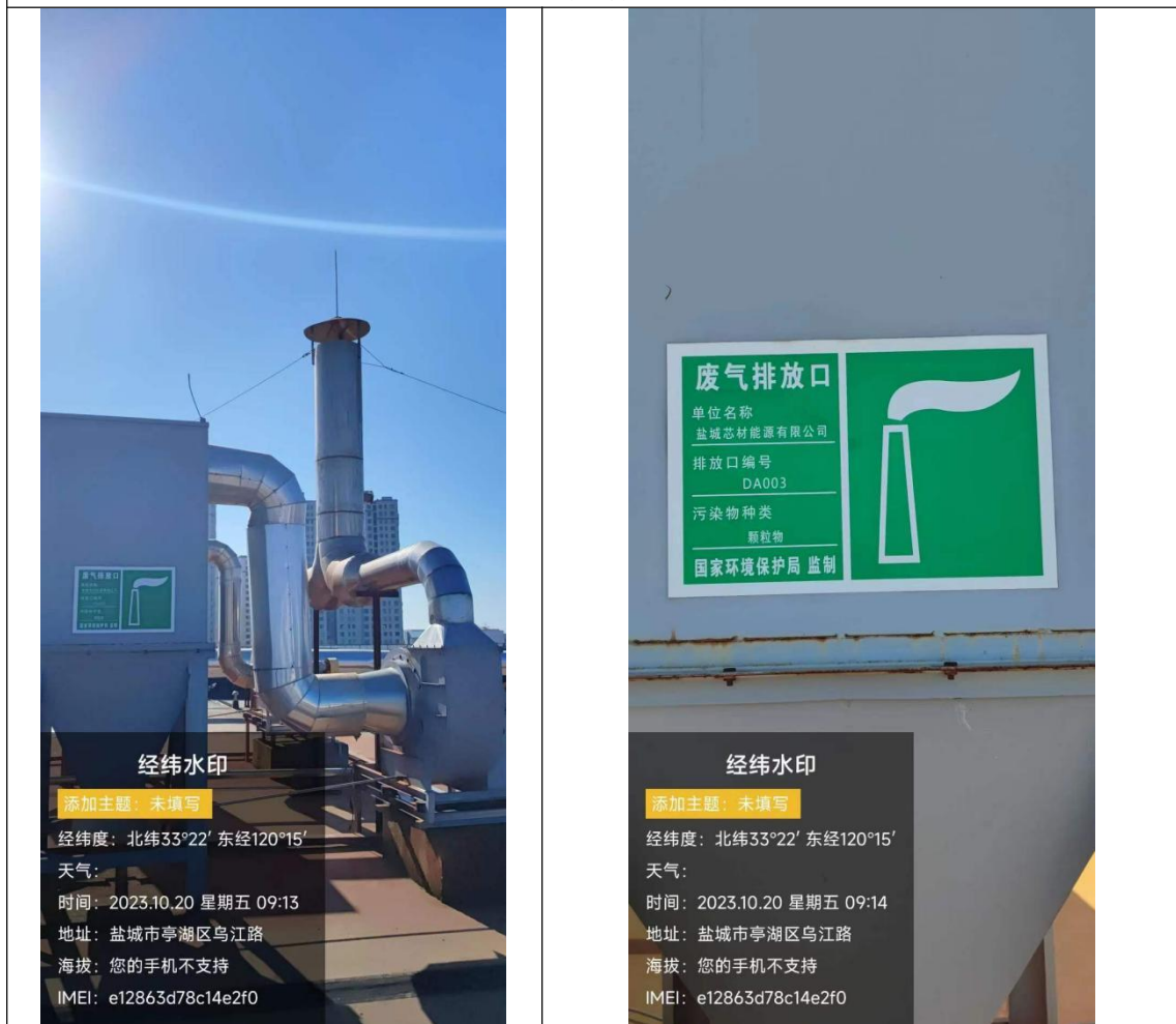
DA003 排气筒及标识
