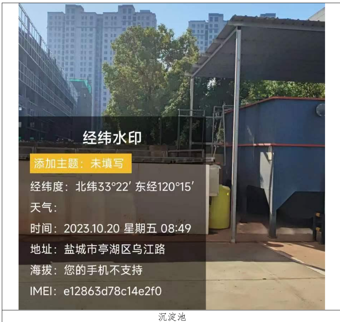
图 3.9-3 现有废水污染防治措施现场照片
